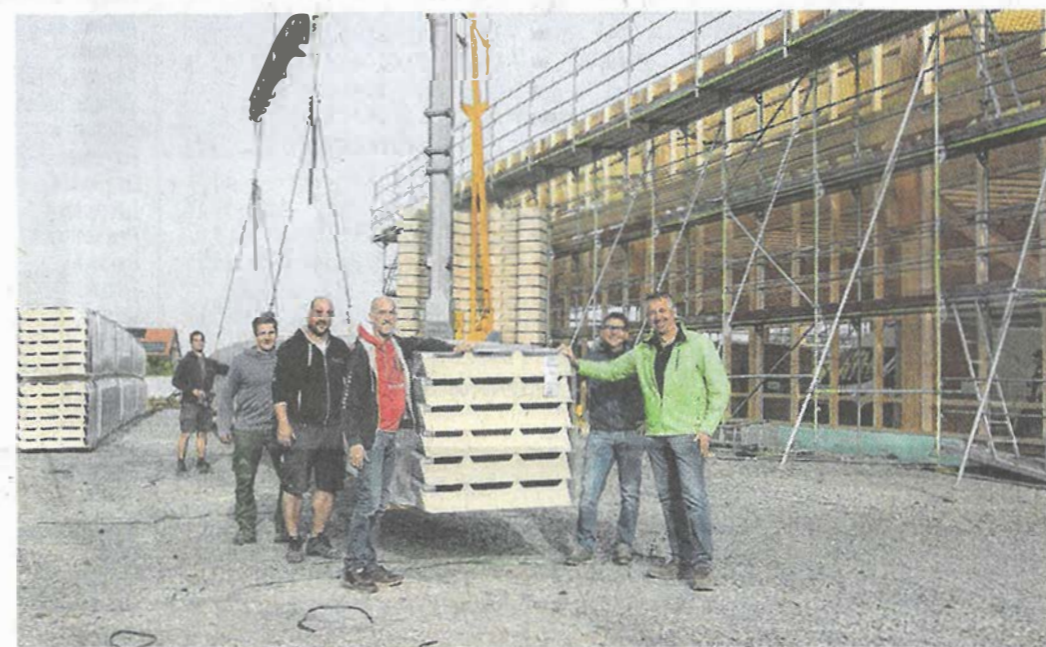
Vertreter der beteiligten Firmen Hof Engelhardt, Zimmererei Pröllochs und Profitec nehmen die Dach-Elemente in Empfang. Foto: ina
